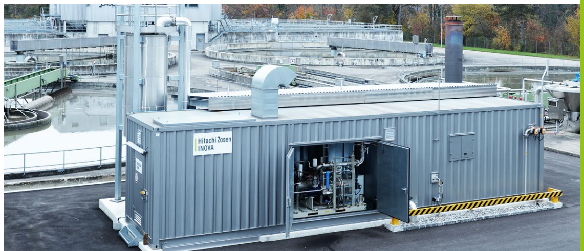
Aufbereitung von Klärgas mittels Membrantechnik in Zuchwil/CH
